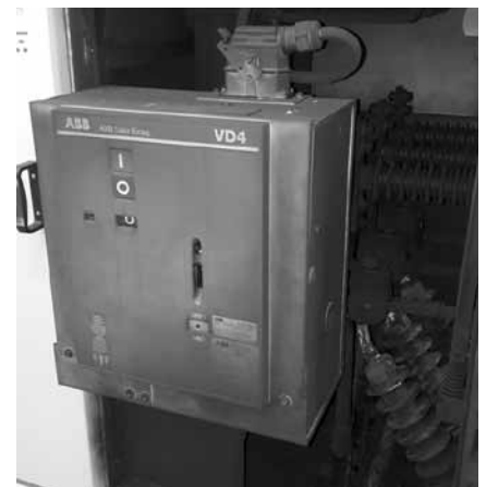
Die Trafostation «ARA» hat nach dem Kurzschluss enormen Schaden genommen.
