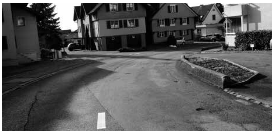
Der Zustand der Oberdorfstrasse bedarf einer dringenden Sanierung.
