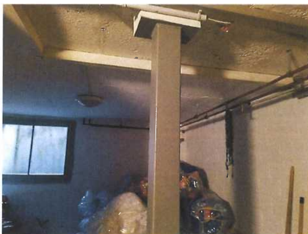
Decke UG Altbau, Heizungsrohre ohne Dämmung
