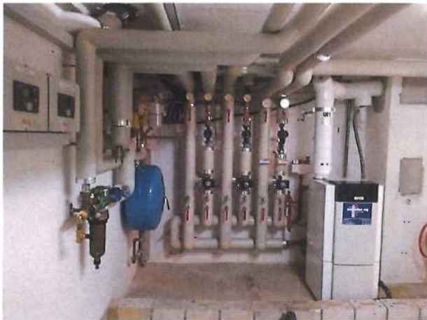
Gasheizung mit Wärmeverteilung
