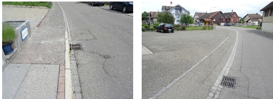
Abbildung 2 und 3: Typischer Belagszustand von der Weierenstrasse (Quelle: Feldaufnahme 11.06.2020)
