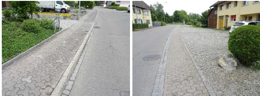
Abbildung 4 und 5: Typischer Zustand Verbundstein Trottoir (Quelle: Feldaufnahmen 11.06.2020)
