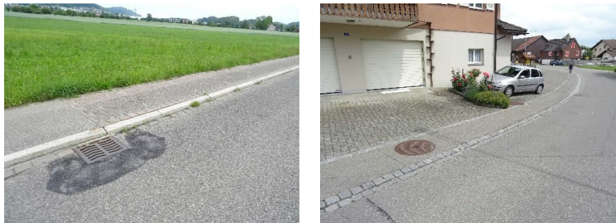
Abbildung 6 und 7: Typischer Zustand Abschlüsse (Quelle: Feldaufnahmen 11.06.2020)
