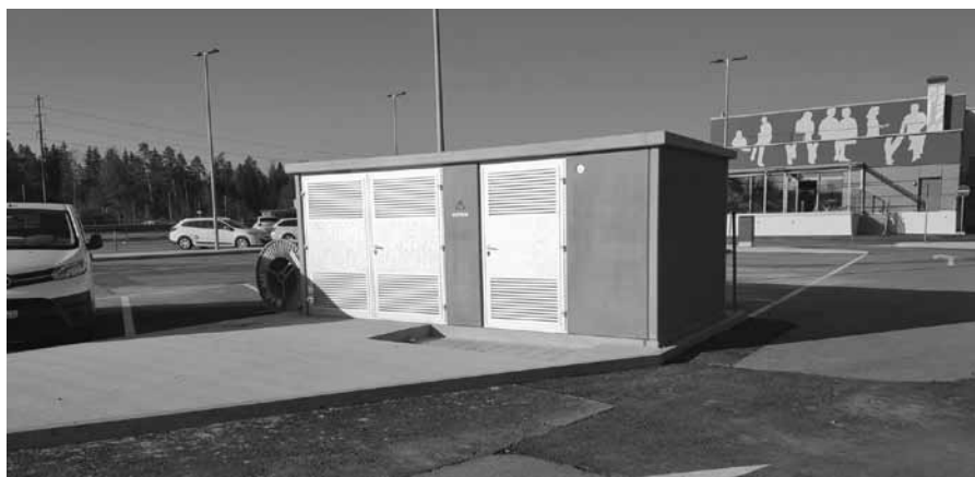
Die neue Trafostation bei der Raststätte «Thurau Nord».
