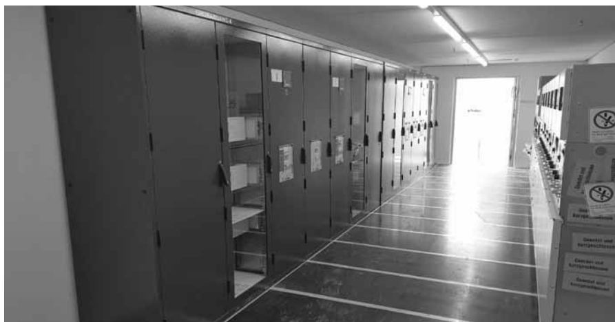
Niederspannungshauptverteilung bei der Trafostation Morach
