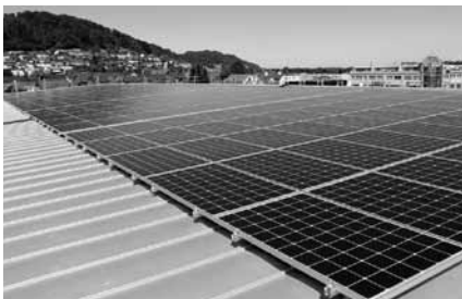
Photovoltaikanlage auf der Sporthalle
